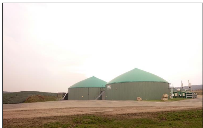
Abb. 8: Biogasanlage mit Fermenter, Nachgärbehälter und Silagelager (EIGENE AUFNAHME)
