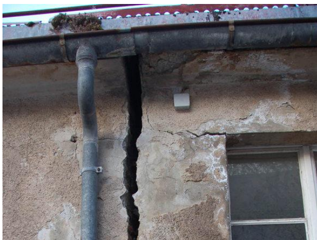
Abb. 13: Gebäudeschäden in Staufen i. Br. nach Bohrungen zur oberflächennahen geothermischen Nutzung (HODEIGE 2009: www)
